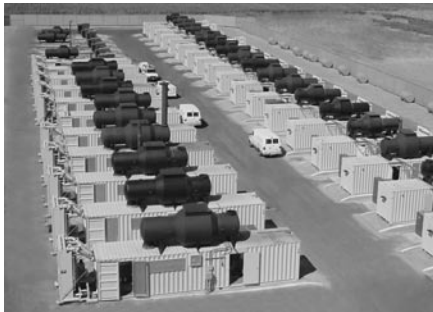
Una instalación Bi-Fuel® de 60MW para cortar picos de carga en horas punta.
